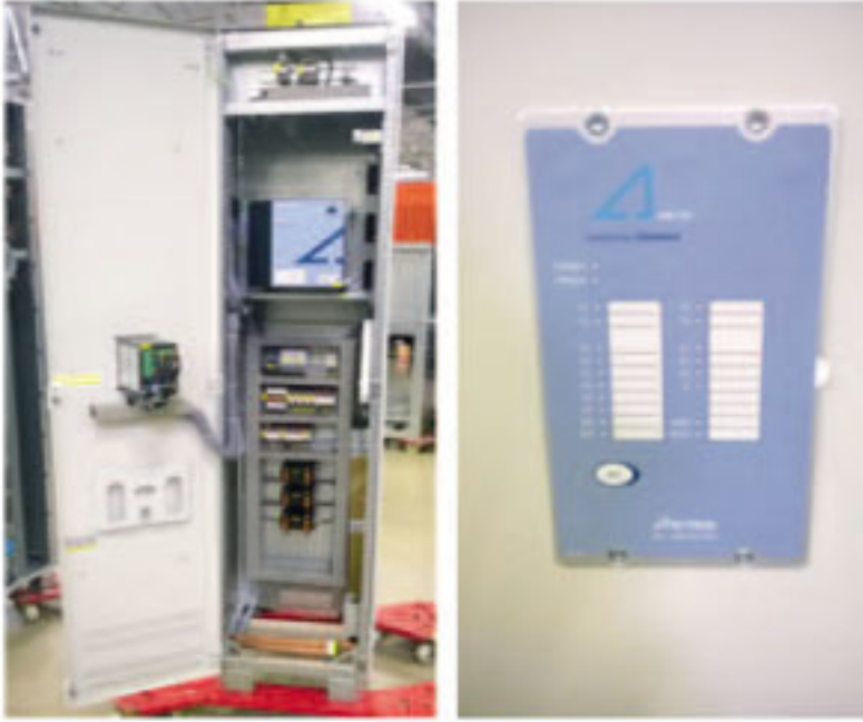
Resim-1 : Ark Söndürme ünitesi ve röle pano yerleşimi
